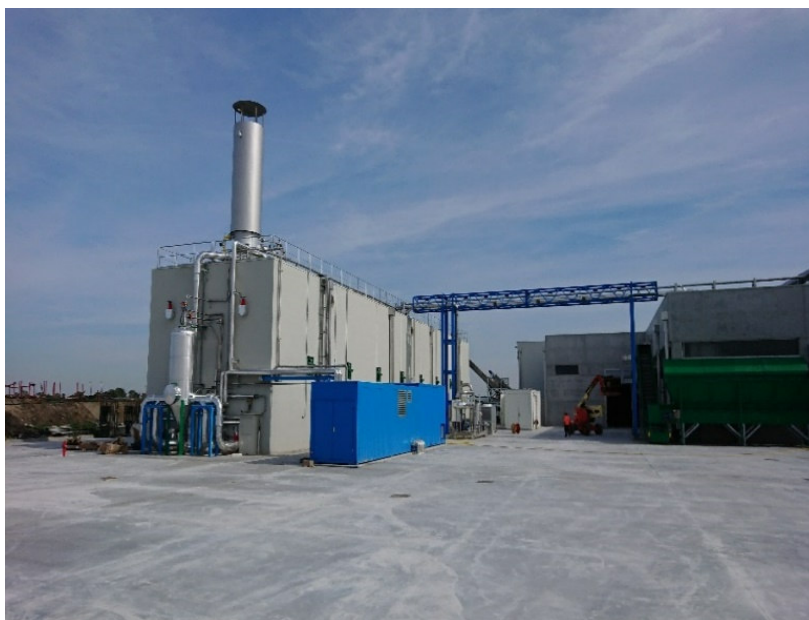
Figura 8: sezione di digestione anaerobica.
